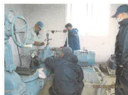
ポンプ点検・整備 【長寿命化活動】
