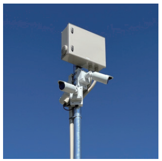
増設された防犯カメラ
