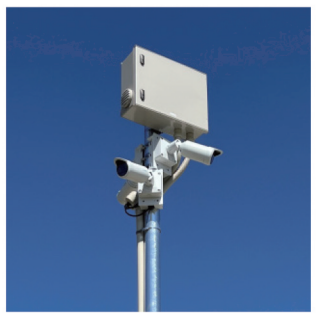
増設された防犯カメラ
