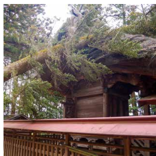
被災した鹿島神社本殿
