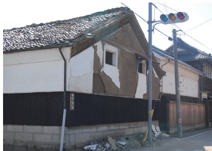
東日本大震災-損壊した土蔵(1)
