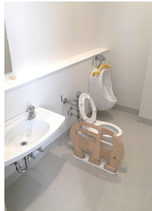
子供用トイレ-さくらがわ地域医療センター
