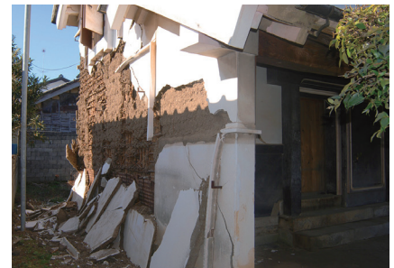
東日本大震災-損壊した土蔵(2)
