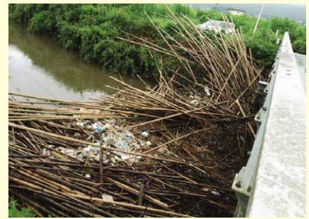
大雨時には氾濫の原因になることも
