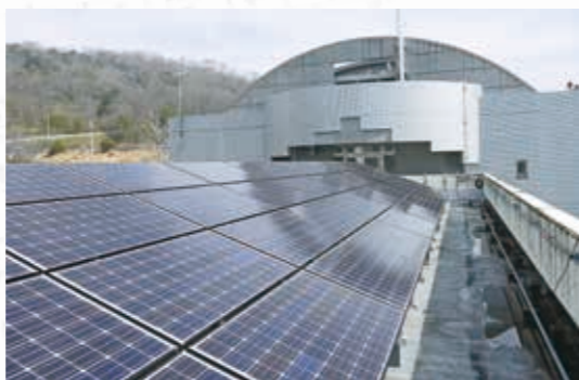
桜川市役所大和庁舎屋上に設置された太陽光パネル
