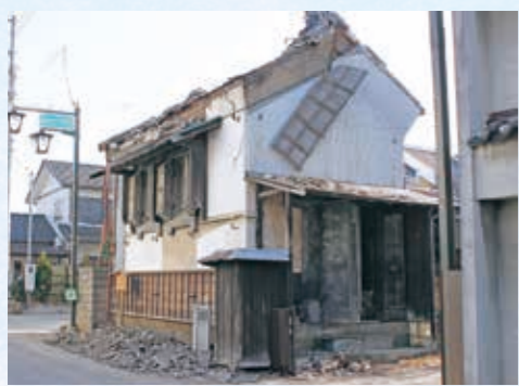
真壁の伝統的建造物も甚大な被害を受けました。
