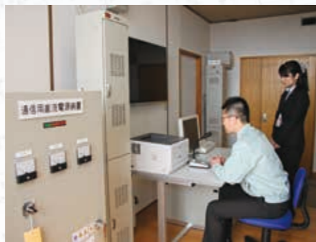
大和庁舎に設置された親局設備
