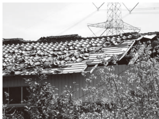
竜巻による被害を受けた納屋
