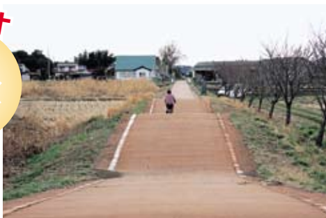
道路が波打っています。スピードを出しすぎると自転車走行は危険です。
