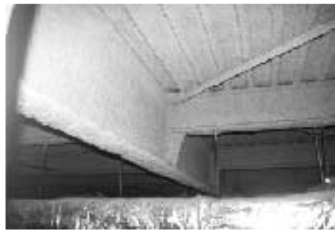
(例) アスベストが吹き付けられた状態
