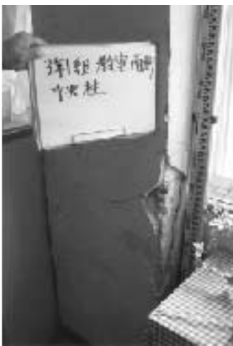
老朽化した柱
