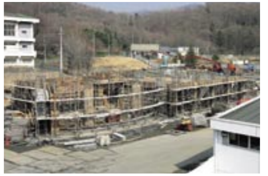
懸案事項の老朽化した大和中学校の改築工事も安全・安心な学校づくり交付金や合併特例債を活用して着工することが出来、12月には、完成する運びとなっております。 【写真／年内完成を目指して、改築工事中の大和中学校】
