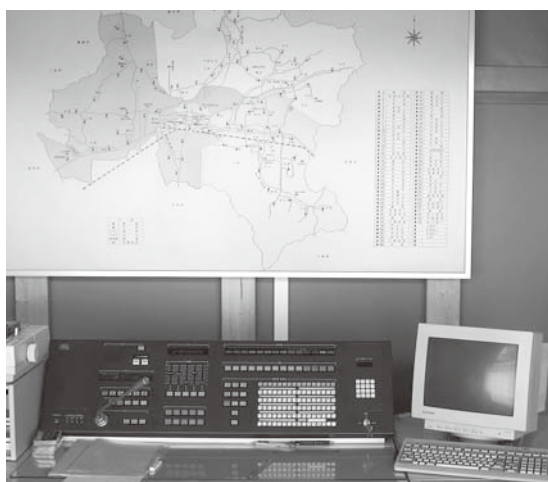
岩瀬庁舎の防災無線室
