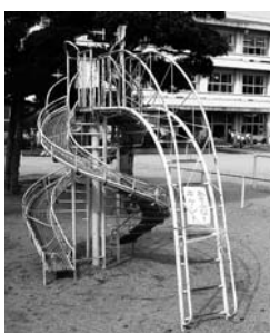
破損している遊具（岩瀬小学校）
